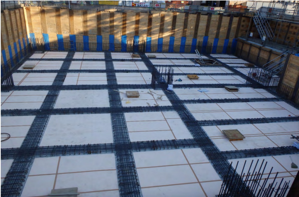
7月12日現在 下記配筋型枠にコンクリートを流した後に地下スラブ張り完了
